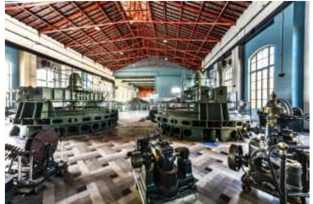
salle des turbines
